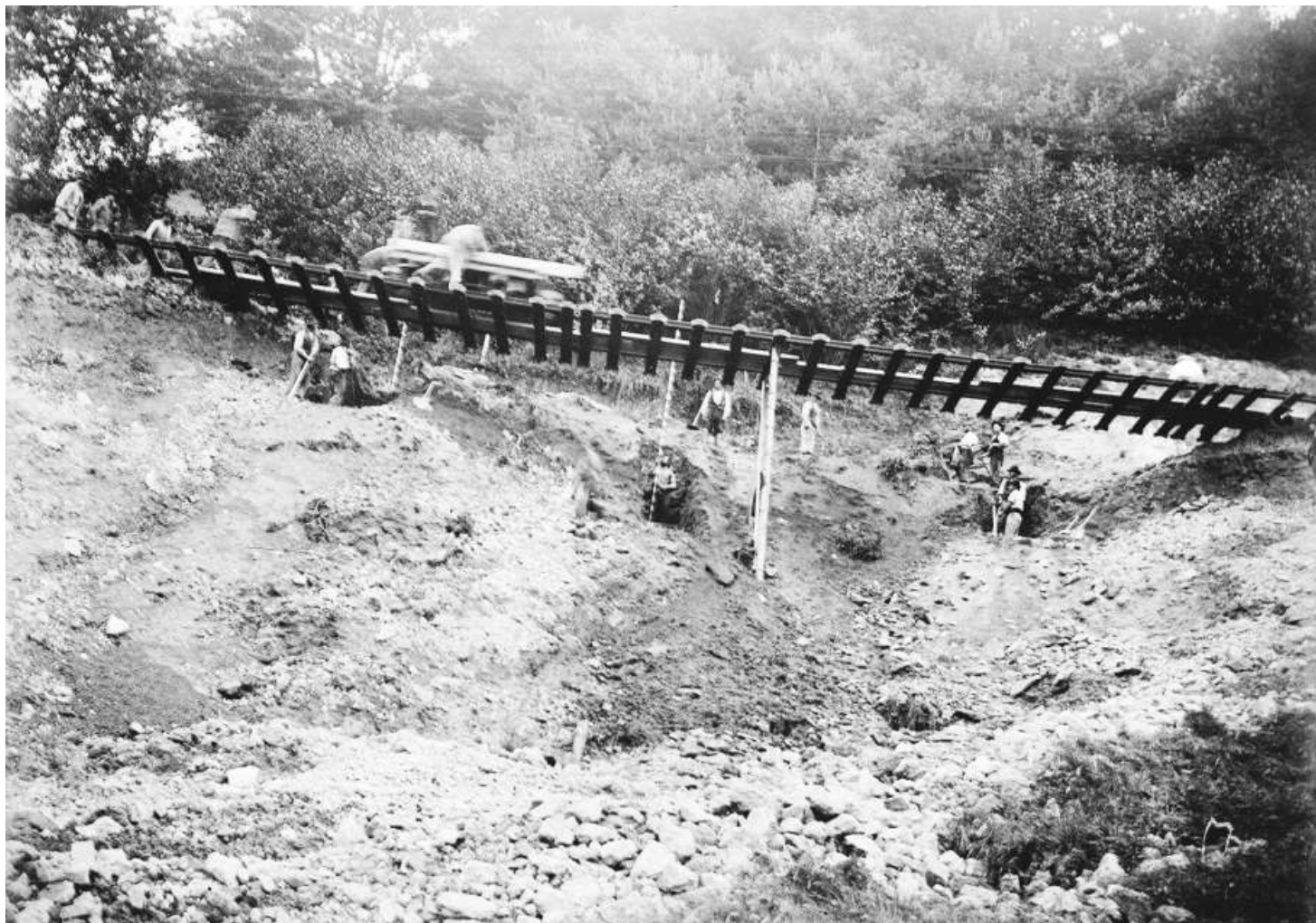
Das Hochwasser vom 14./15. Juni 1910 führte zu diesem eindrücklichen Dammrutsch zwischen Hörndli und Grafstatt. Kaum zu glauben: Innerhalb von 6 Tagen wurde eine «Gerüst-Brücke» aus Holz erstellt und die Züge fuhren wieder. 1910 wurde noch mit Dampflok gefahren, die deutlich leichter als die späteren Elektroloks waren.
