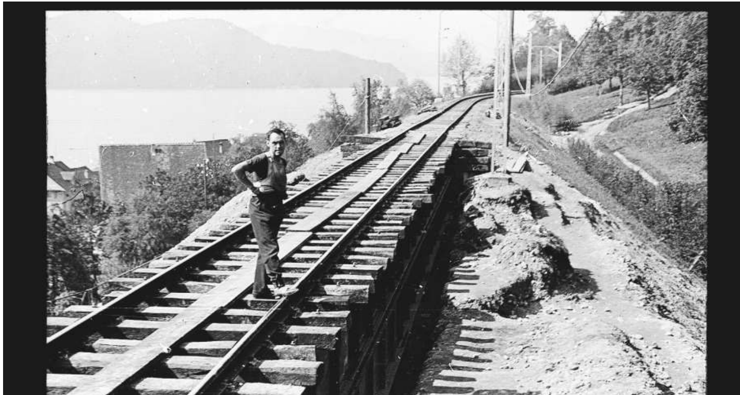
Keine Ruhe auf dieser Strecke – beim grossen Hochwasser von 1934 brach der Damm beim Walchwiler Hörndli quasi in sich zusammen – das Material floss aus dem Durchgang über die Strasse in den See. Die Stelle befindet sich 200 Meter weiter südlich des Dammrutsches von 1910, bei der heutigen Haltestelle Hörndli.
