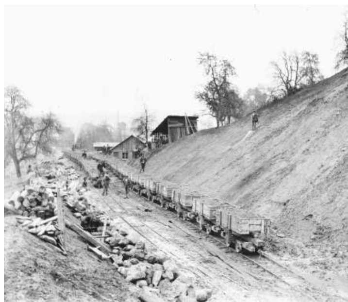
1895: Der Viadukt zum Bahnhof ist erstellt, die Materialtransporte auf dem Einschnitt beim Guggi laufen. Bild: Fotosammlung Bibliothek Zug
